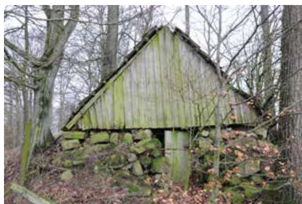
Understa bilden t b: Inbyggd i en backe finns en äldre förrådsbyggnad, möjligen en tidigare jordkällare, av sten och trä. Den kulturhistoriskt intressanta byggnaden har stora behov av underhåll. Slättaröd 3:3.
