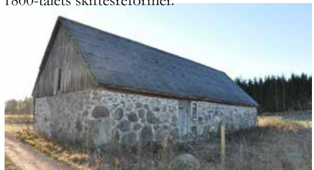
Ekonomibyggnad i gråsten och stående träpanel. Ett ålderdomligt element i ett odlings- och beteslandskap med höga kulturvärden.
