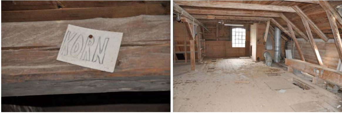
T v: takbjälke inne i kvarnen, där bl. a. korn hanterades. T h: kvarnens andra våningsplan. Observera vädringsluckan i fönstret och spannmålsfickorna i trä. I lokalen fanns tidigare flera motordrivna matarskruvar. Idag finns bara en matarskruv kvar ( till höger i bilden). Hålen i golvet visar var de andra var placerade.
