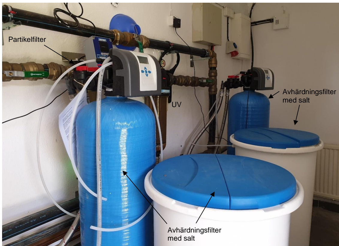
Bild 8. Foto taget av Tyréns under platsbesök 20190823, inifrån rum för vattenberedning.
