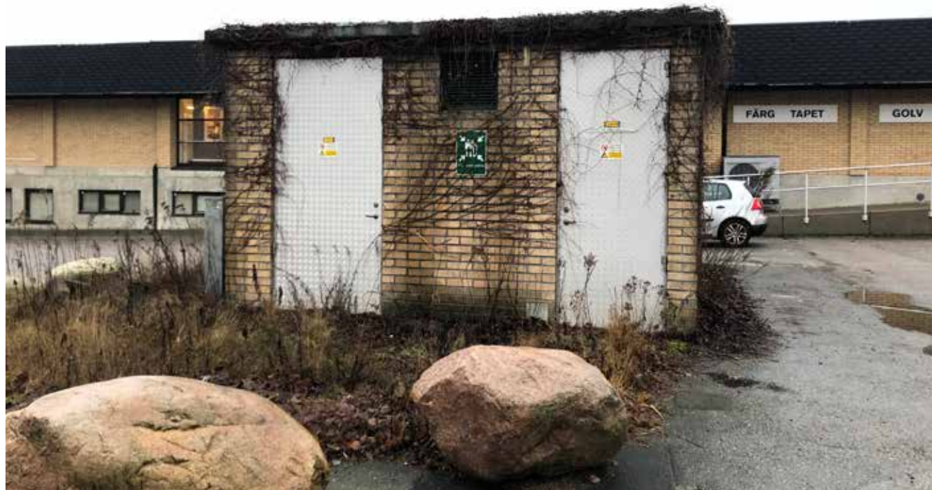
Hällbo 11, befintlig transformatorstation
