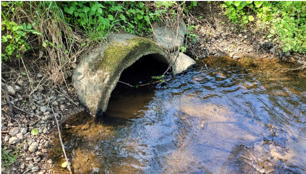
Figur 11. Befintlig trumma under gångväg i västra delen av planområdet. Trumman är delvis igensatt av sediment, vilket kan begränsa dess kapacitet.
